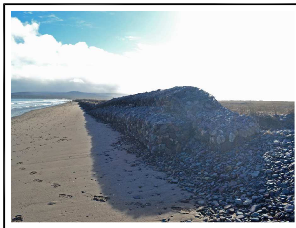
- Gabions sur l'Isthme à la "Dune"- (après les assauts de la mer)
